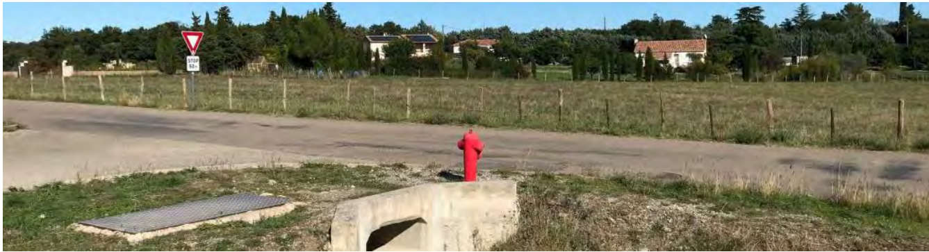
Borne incendie à proximité immédiate du site du projet.
