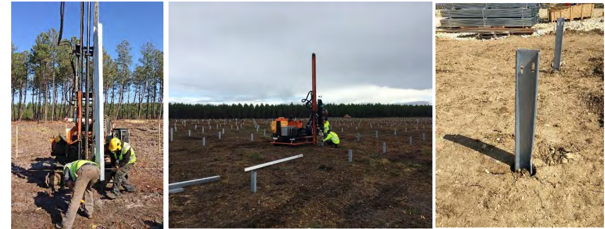
Exemples de mise en place des pieux battus sur les chantiers URBASOLAR
