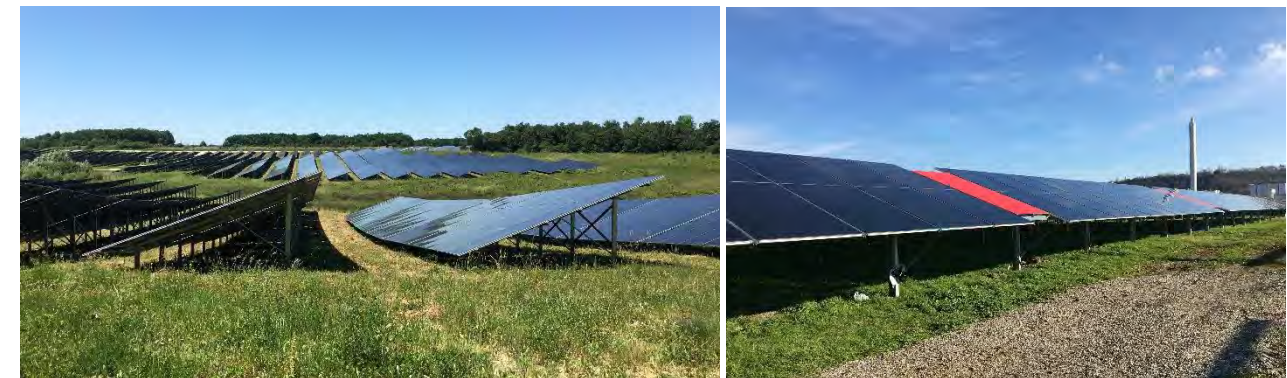
Exemples de réalisations Urbasolar : Nersac (16) et l'Oncopole de Toulouse (31)
